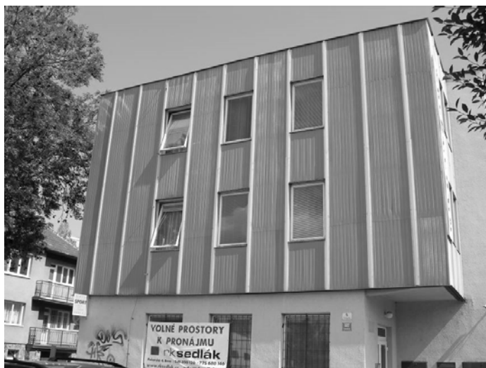
Obr. 3 Obvodový plášť administrativní budovy (z roku 1980), lehkých panelů s obsahem azbestu, Brno, 2012 Fig. 3 External cladding of administration building (built 1980) from light panels with asbestos content, Brno, 2012
